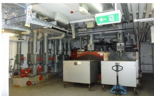
Pôvodné kotle v kotolni
