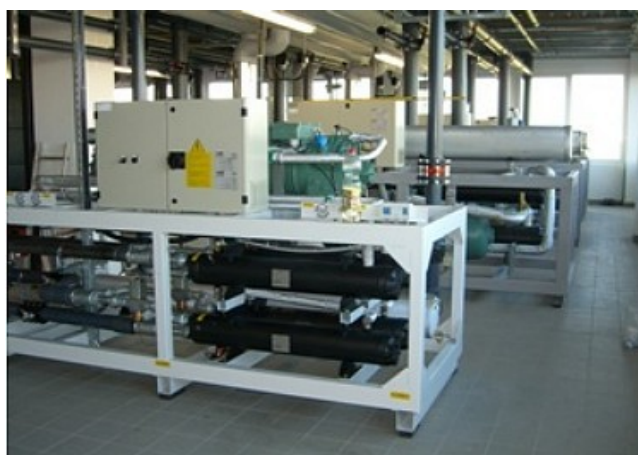
Kompresor - chladiace zariadenie
