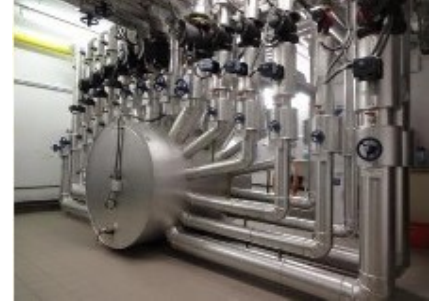
Raiffeisen Bank Bregenz 780kW chladenie -kúrenie
