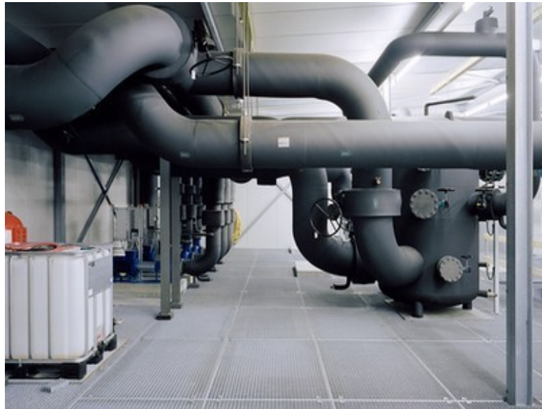
Datacenter Rümlang Švajčiarsko chladenie – 4.8 MW
